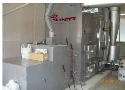
ペレットボイラー
