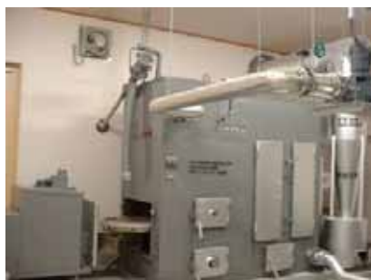
ペレットボイラー
